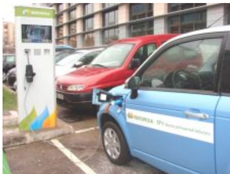
Recarga de vehículo eléctrico
